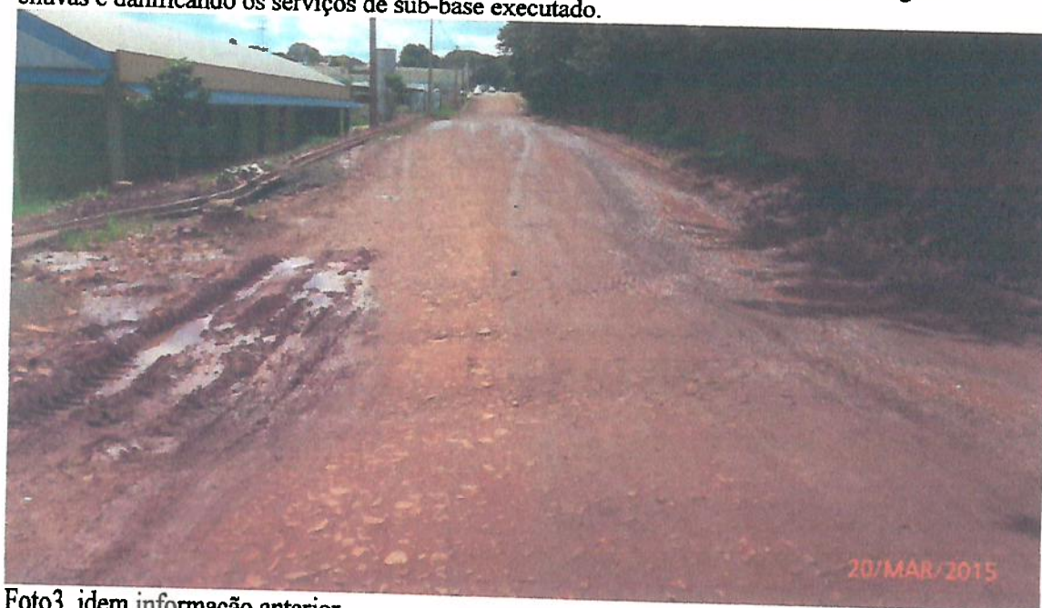
Foto2, conforme mostra a foto, está ocorrendo diversos pontos de empoçamento de águas de chuvas e danificando os serviços de sub-base executado.
