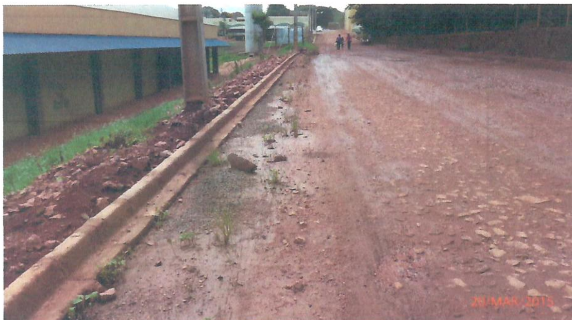
Foto7, conforme mostra a foto, não foi deixada a espessura suficiente para a execução da base de brita graduada com 15,00cm de espessura.
