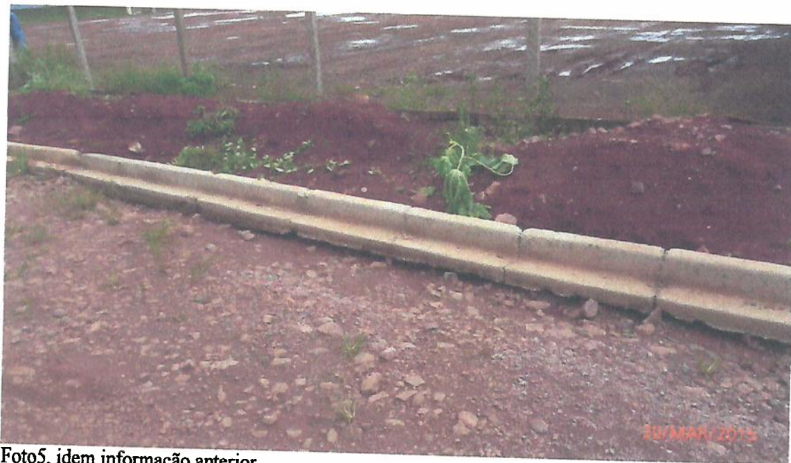
Foto4, conforme mostra à foto, a enxurrada está estragando o meio fio com sarjeta executado.
