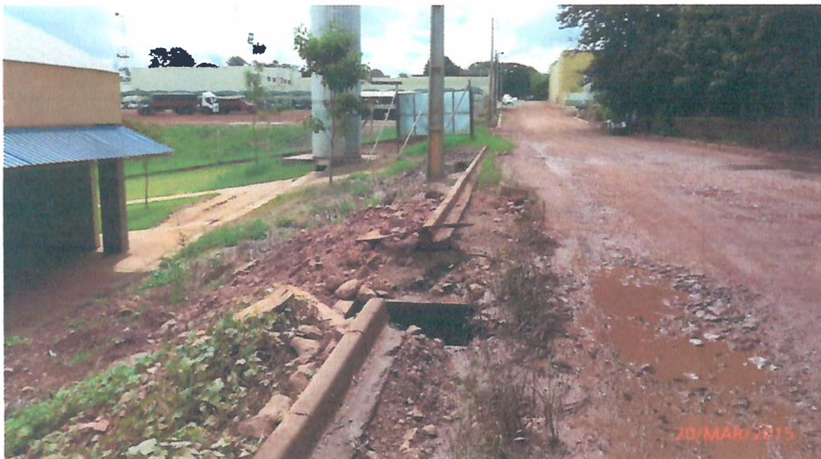
Foto6, conforme mostra à foto a obra, há diversas caixas de drenagem que estão abertas possibilitando a ocorrência de acidentes com pedestres e veículos.
