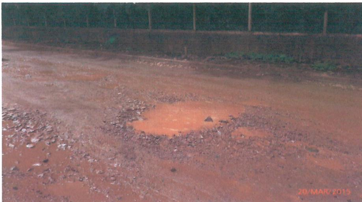
Foto2, conforme mostra a foto, está ocorrendo diversos pontos de empoçamento de águas de chuvas e danificando os serviços de sub-base executado.
